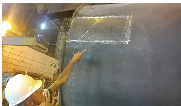
Técnico da Secretaria Municipal de Meio Ambiente de Açailândia mostra a reparação feita no furo que provocou o acidente antes da realização da perícia. ©Semma
