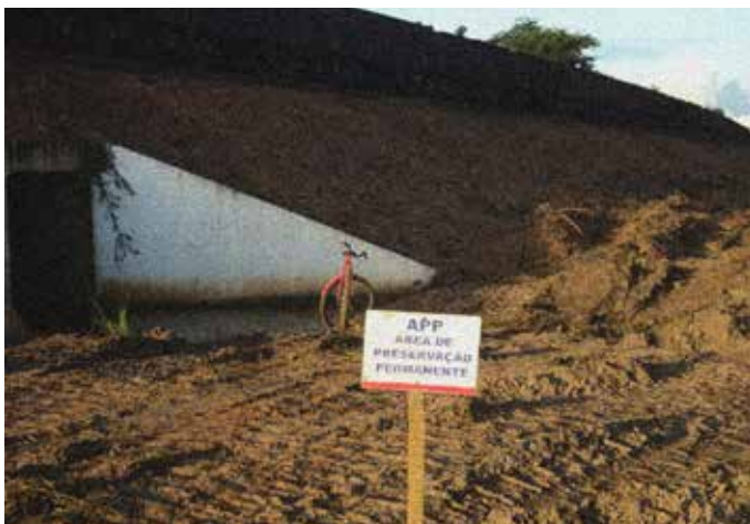
← Igarapé Capim Açu durante as obras de duplicação da ferrovia, 2015. Arquivo rede Justiça nos Trilhos
